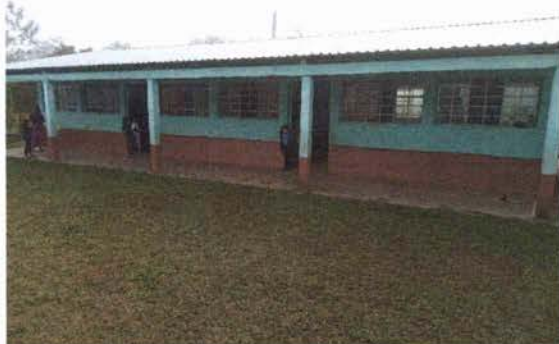
Foto 1: Se observan daños en las paredes y desprendimiento de la pintura en el módulo 4
